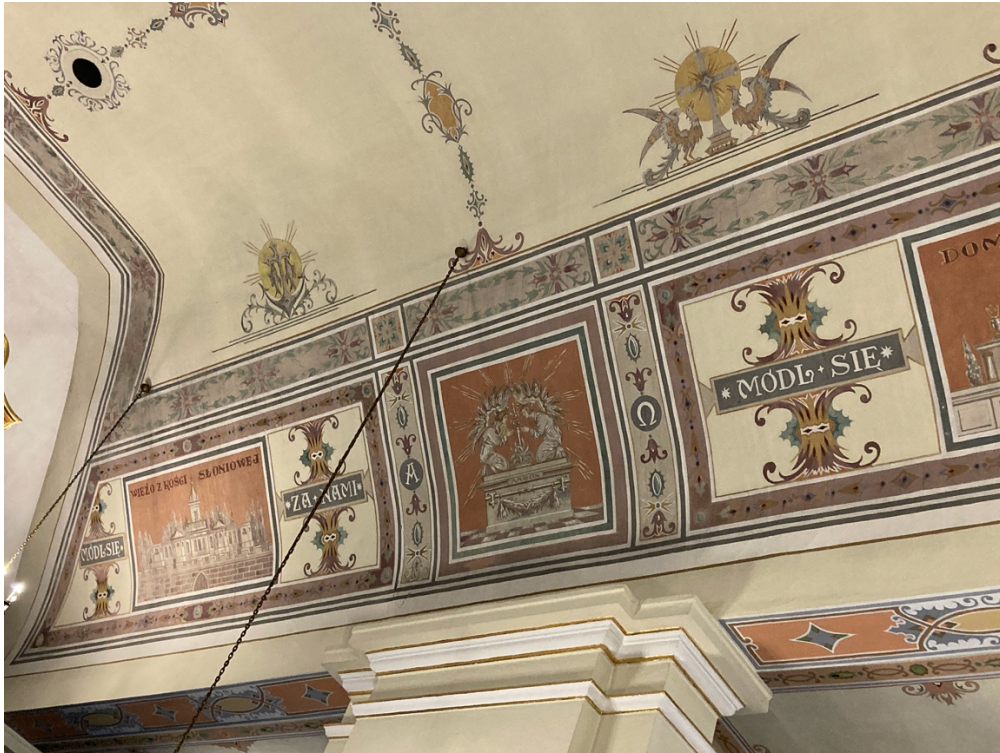
Fot.3. Fragment sklepienia z bogatą polichromią – prawa strona, stan przed konserwacją.
